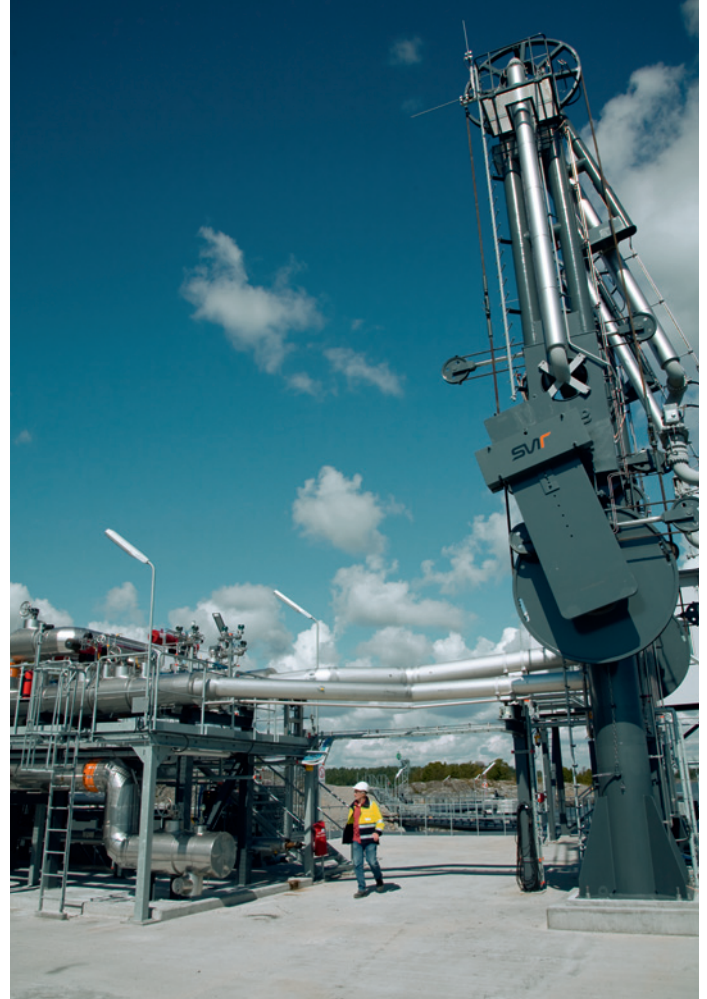
LNG loading arms, Nynäshamn LNG terminal, Sweden
