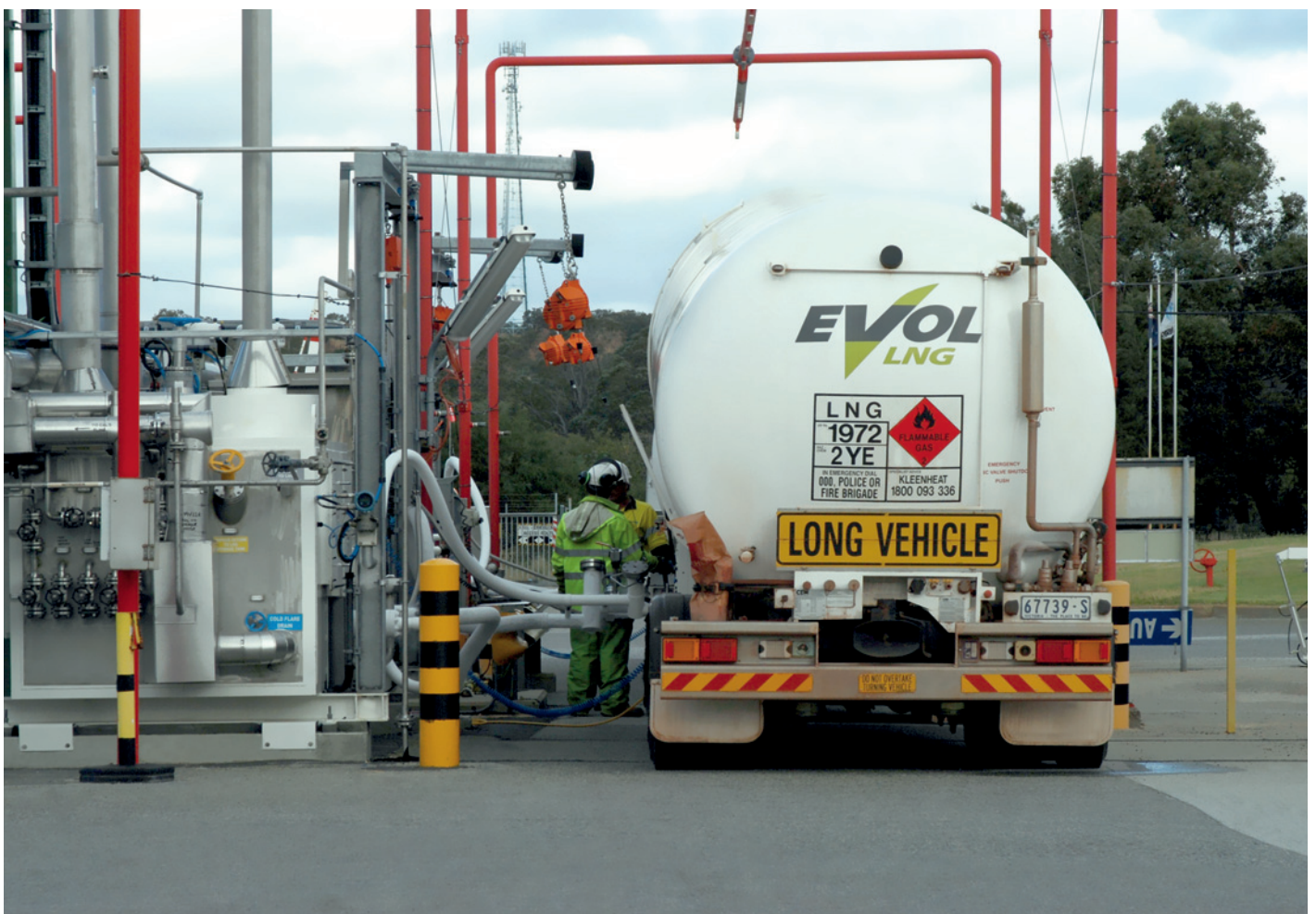
LNG truck loading, Kwinana LNG plant, Australia
